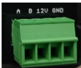
Svorkovnice vyhodnocovacej jednotky v rozvádzači
